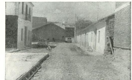
Carretera Alfara-Vinalesa, de reciente realización. Este angosto paso ha sido ensanchado hasta el agujero practicado en la pared de la «Unión Conservera, S. A.»
